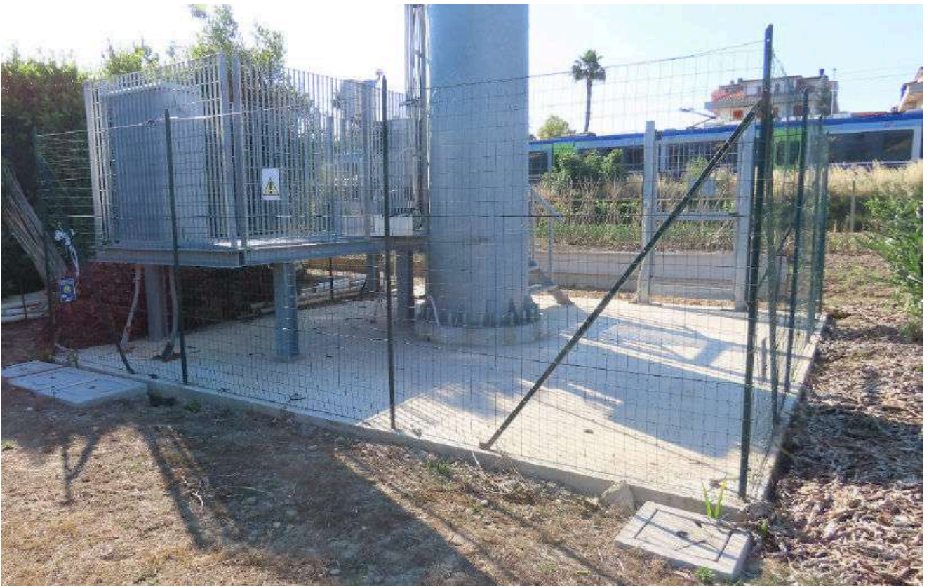
Fig.23: Struttura portante l'elettronica della SRB anti alluvione
